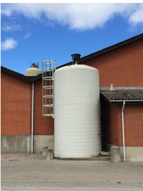
Hybridfilter med ventilator monteret på opsamlingsbrønd. Luftskifte 3 gange i timen.
